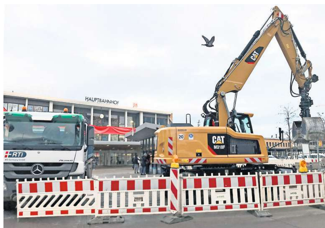
Geduld ist bei den Passanten gefragt. Die Arbeiten am Bahnhofsvorplatz sind noch nicht abgeschlossen. FOTO: ALEXANDER RATHS
